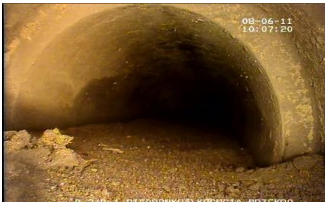
Zły stan techniczny systemu odwodnienia
