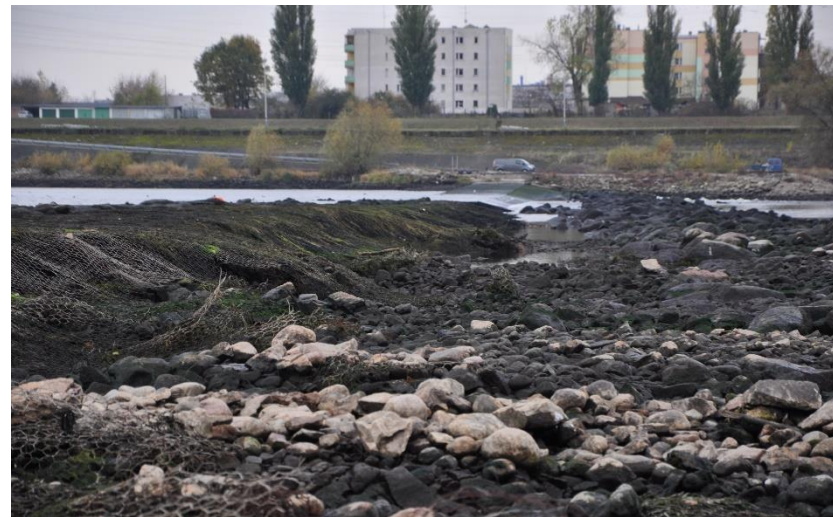
Stan techniczny tymczasowego progu podpiętrżającego SW Włocławek – zdjęcie z dnia 30 października 2018 r.
