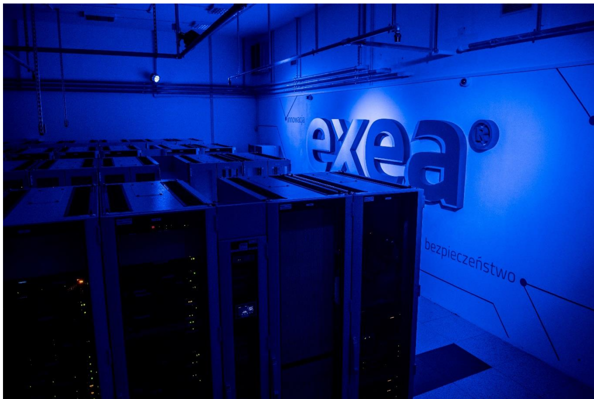
Serwerownia w Exea Data Center, fot. Łukasz Piecyk
