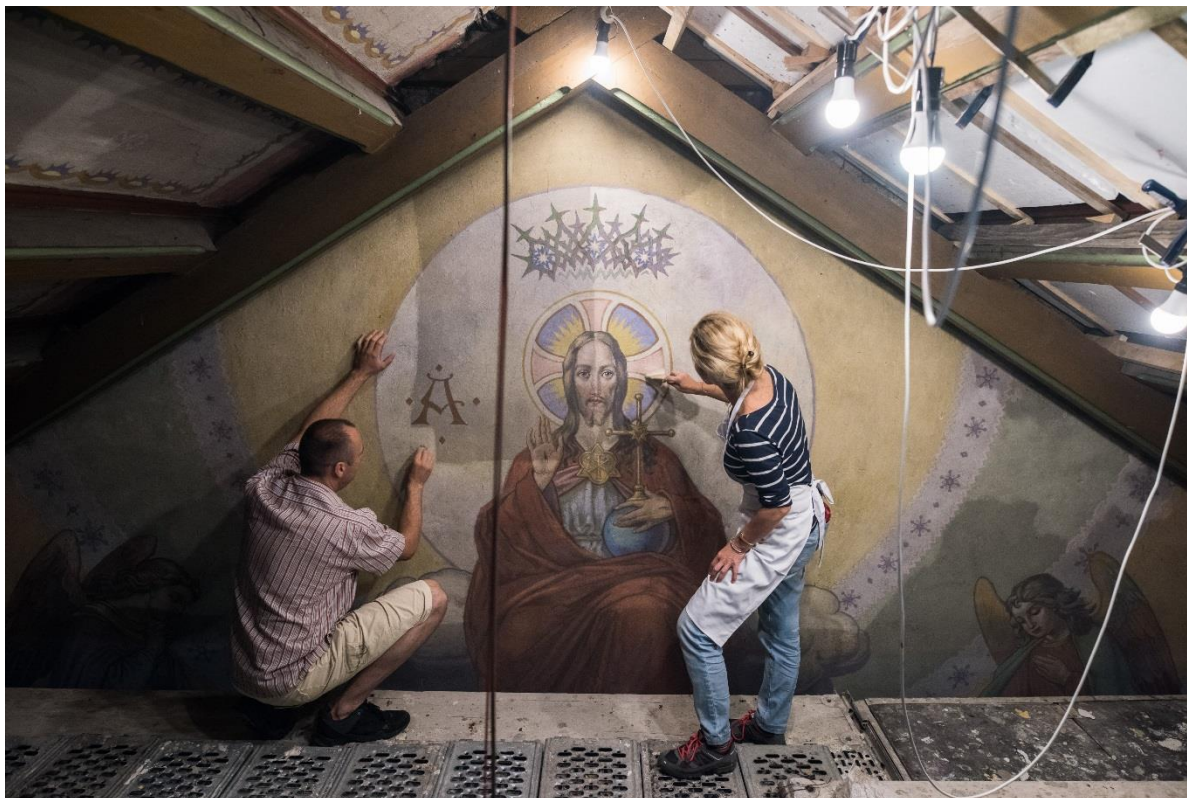
Renowacja kościoła pw. Niepokalanego Poczęcia NMP w Nowej Wsi Wielkiej, fot. z archiwum Urzędu Marszałkowskiego Województwa Kujawsko-Pomorskiego
